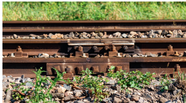
Große Stoßlücke im Oberbau trotz Hochsommer zwischen Seltz und Munchhausen.
